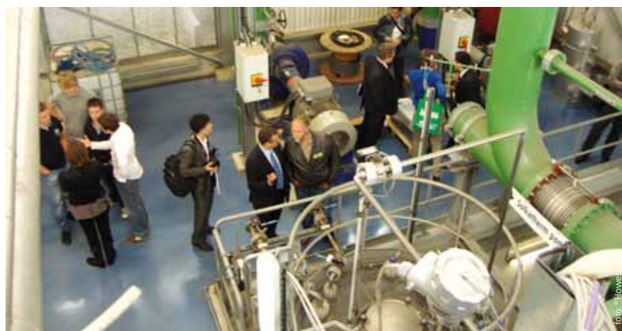
Restwarmterecuperatie in de praktijk
