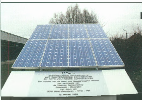
Energiezuinige stookplaats met geïntegreerde zonneboiler voor de bereiding van warm sanitair water bij rusthuis De Nieuwe Lente te Heule.
